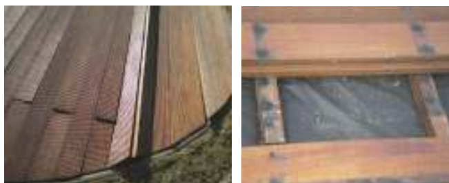
Následek nevhodně použitých ocelových pozinkovaných vrutů do terasy z dubu. Dřevina v okolí vrutů zabarvená, vruty přestřihány vlivem pnutí palubek a zasaženy červenou korozi.
