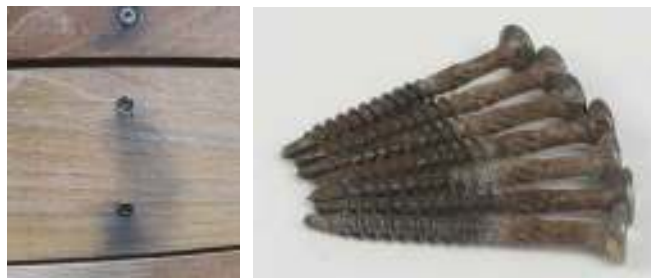
Následek nevhodně použitých ocelových pozinkovaných vrutů do venkovního dřevěného obkladu z akátu. Stav zhruba po 4 měsících po zhotovení spojů. Dřevina v okolí vrutů zabarvená, vruty zasaženy červenou korozi.
