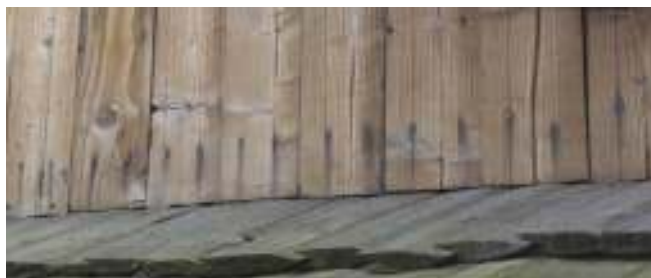
Pro upevnění prken byl použit nevhodný spojovací materiál, dřevina je v okolí spojovacího materiálu zabarvená stékající rzí.
